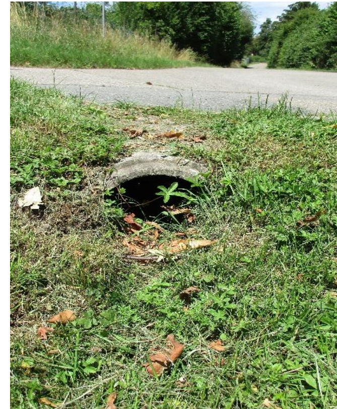
Beispiel eines verkrauteten zugeetzten Einlaufs
